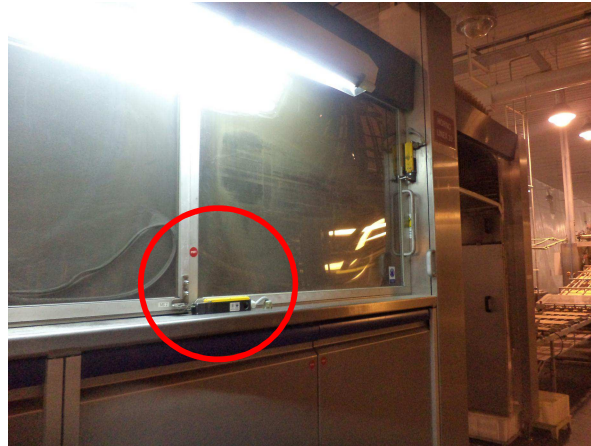
Imagen 25. Microswitch de seguridad en puerta horno Línea 10
