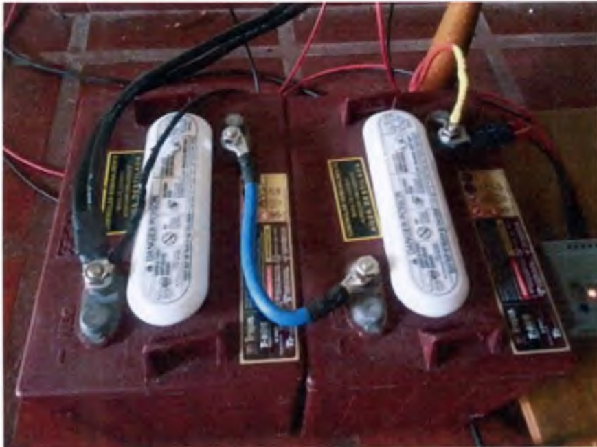
Foto 7.4. Banco de baterías de 220Ah en 12V
