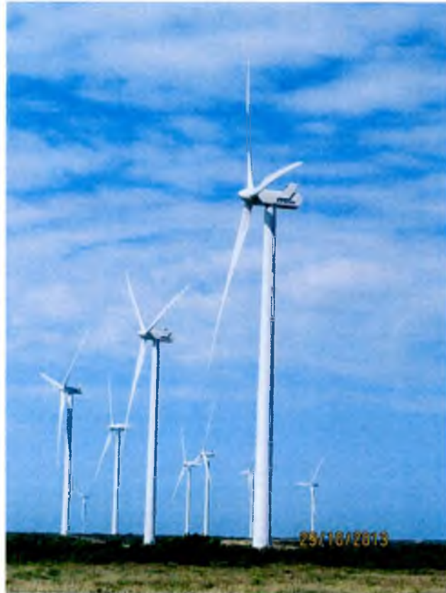
Figura 4.1: Parque eólico Rawson, Chubut. Aerogeneradores de 1.8MW.
