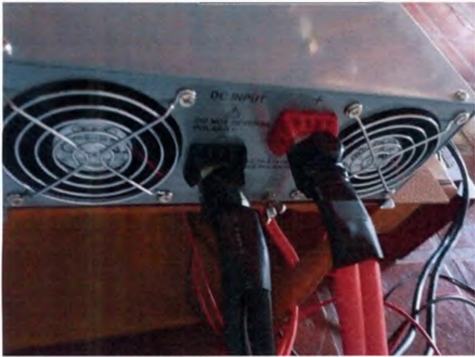
Foto 7.3. Bornes para conexión de las baterías del Inversor
