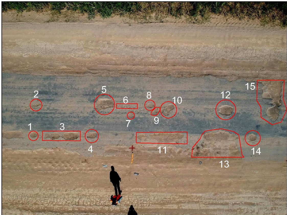
Figura 266: Desintegración por baches. Tramo 1 - imagen 1204.
