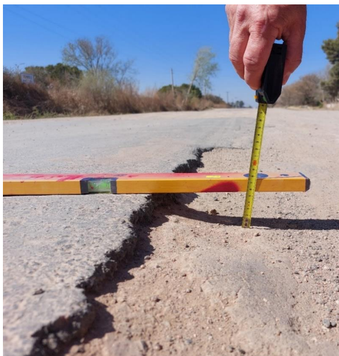
Figura 267: Escalonamiento de borde. Tramo 1 – imagen1.
