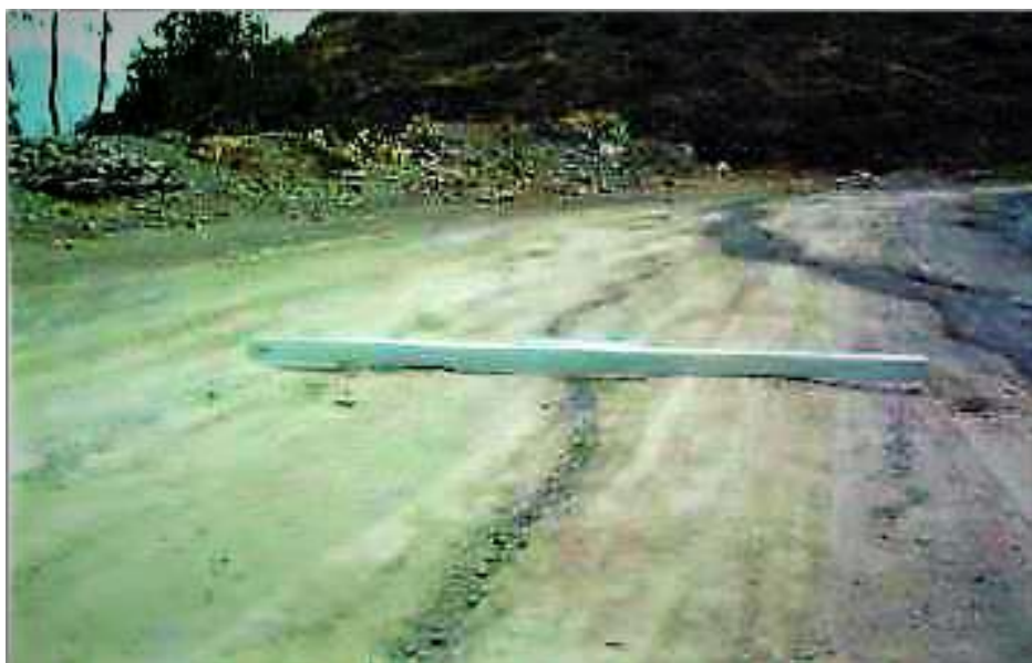
Figura 181: Erosión de baja severidad. 186
