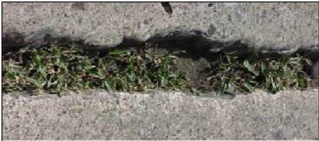
Figura 142: Deficiencia en el material de sello de alta severidad. 147
