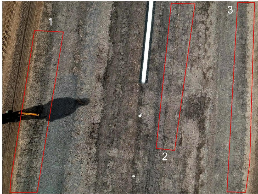
Figura 240: Fisuras tipo piel de cocodrilo. Tramo 1- imagen 0894.
