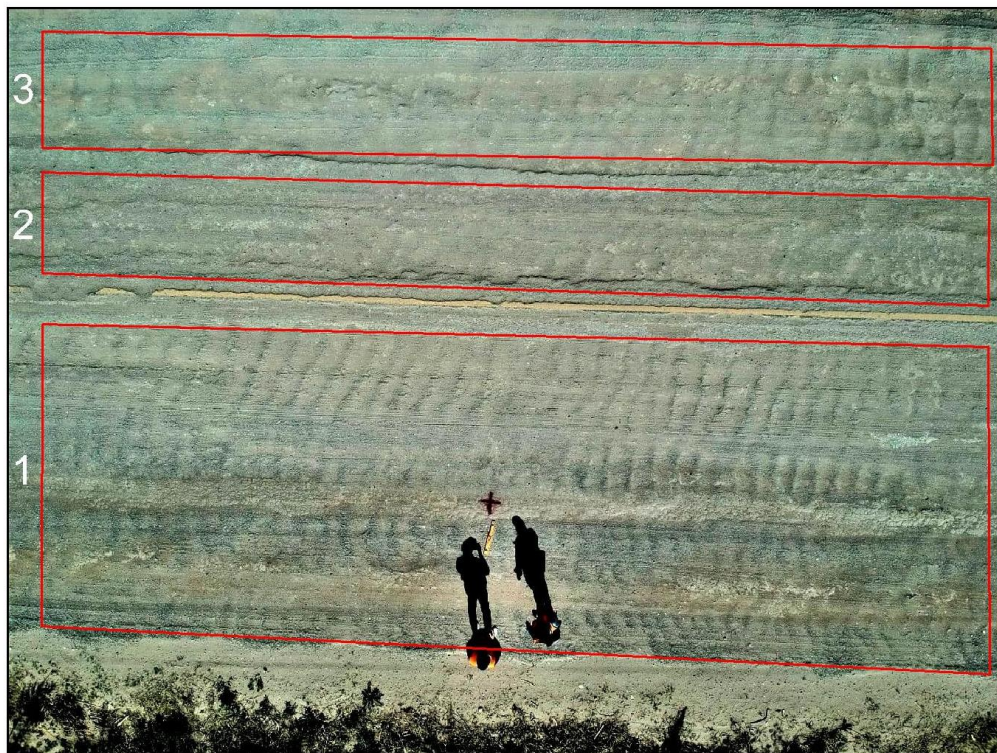
Figura 275: Ondulación/corrugación tramo 2 - imagen 1217.
