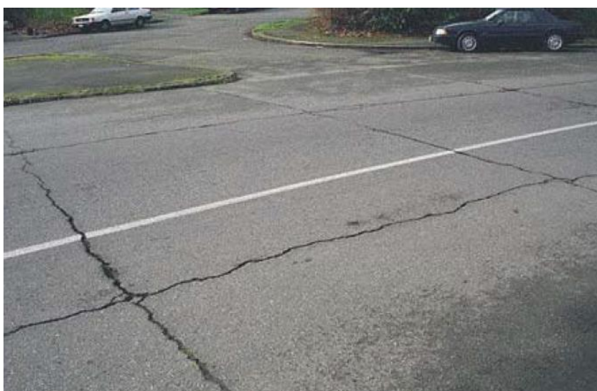
Figura 67: Reflexión de juntas con un nivel medio de severidad. 72
