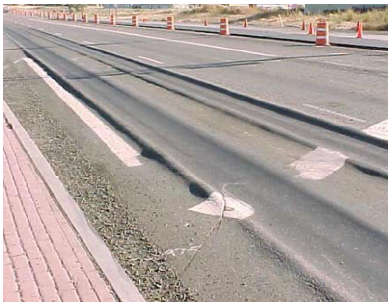
Figura 34: Ahuellamiento de severidad alta, con desplazamiento lateral. 39
