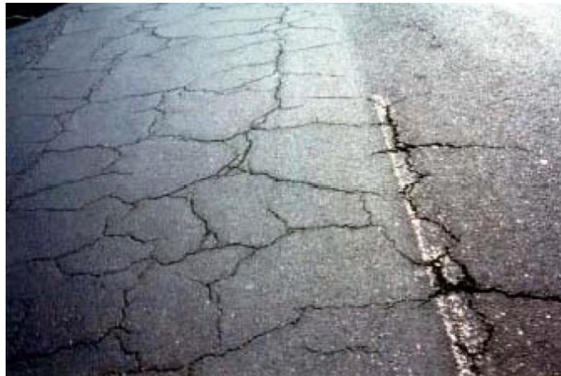
Figura 59: Fisuras en bloque con nivel de severidad medio. 64
