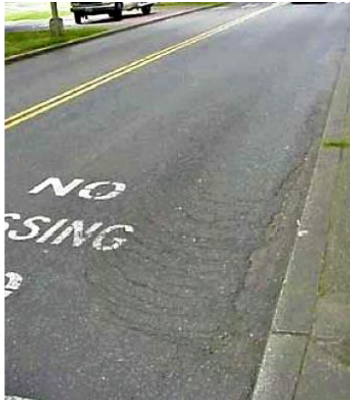
Figura 70: Fisuras en arco con bajo nivel de severidad. 75
