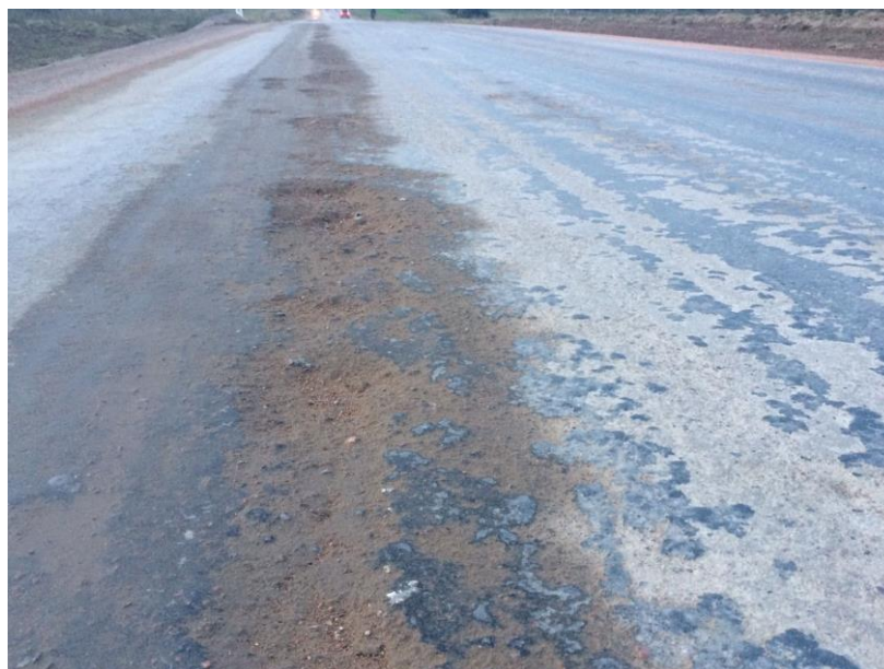
Figura 99:Falla por exudación de agua y bombeo. 104
