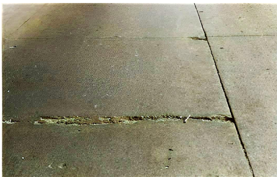
Figura 122: Fisuras transversales de alta severidad. 127
