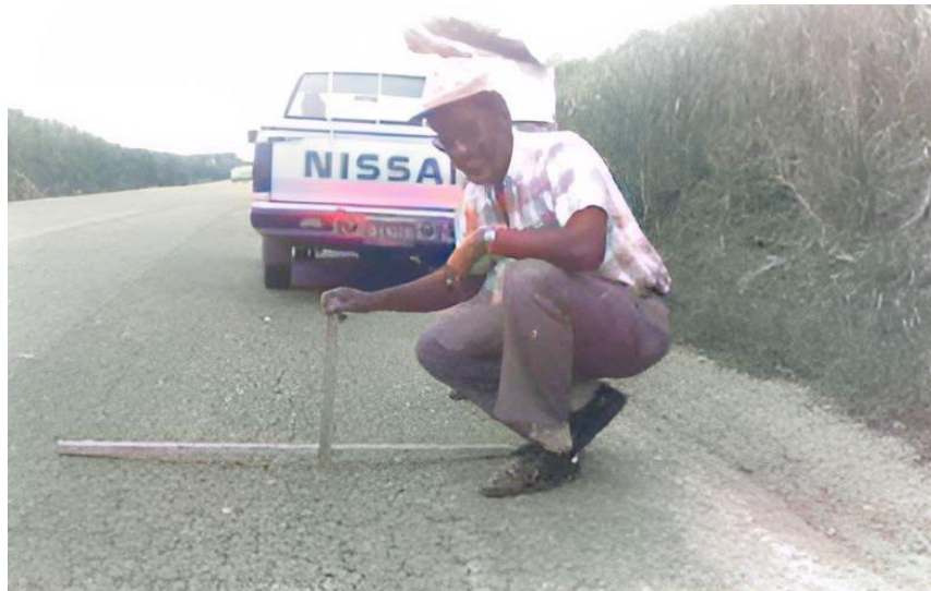
Figura 32: Ahuellamiento de severidad baja con fisuras tipo pie de cocodrilo. 37
