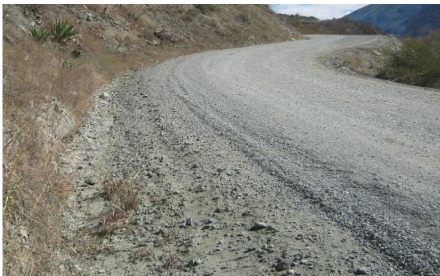
Figura 178: Pérdida de agregados de baja severidad. 183
