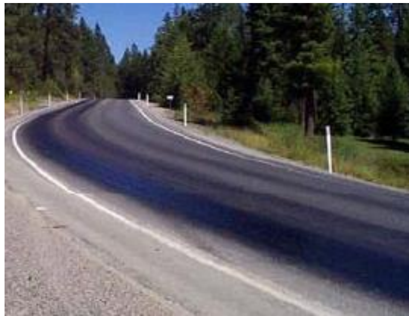
Figura 97: Exudación del asfalto de alta severidad. 102
