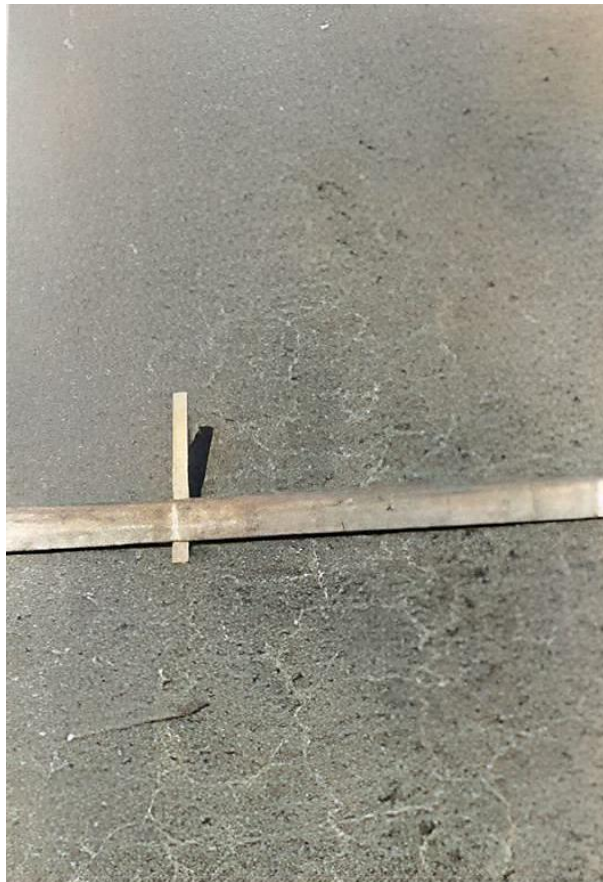
Figura 62: Fisura tipo piel de cocodrilo de baja severidad. 67
