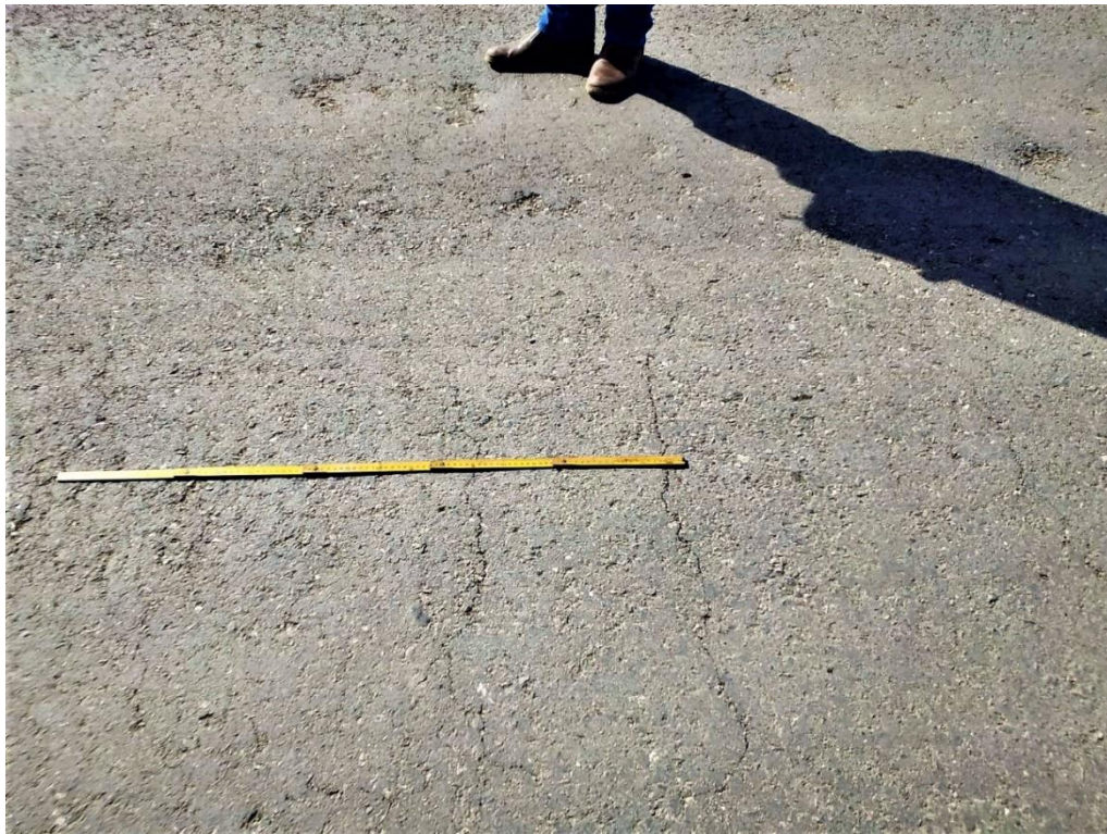
Figura 254: Fisuras transversales. Tamo 3.
