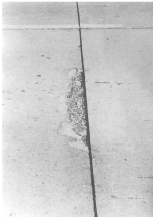
Figura 146: Descascaramiento de juntas de severidad media. 151
