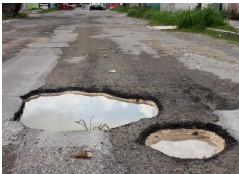
Figura 87: Baches de alta severidad. 92
