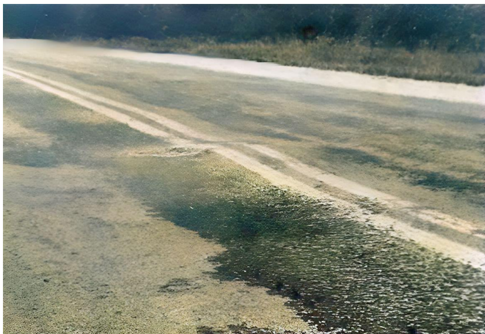
Figura 47: Hinchamiento de alta severidad. 52
