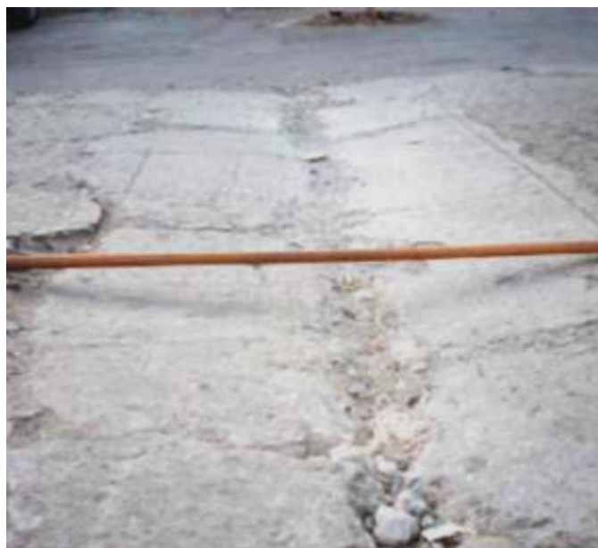
Figura 136: Hundimiento de pavimentos rígidos, de alta severidad. 141
