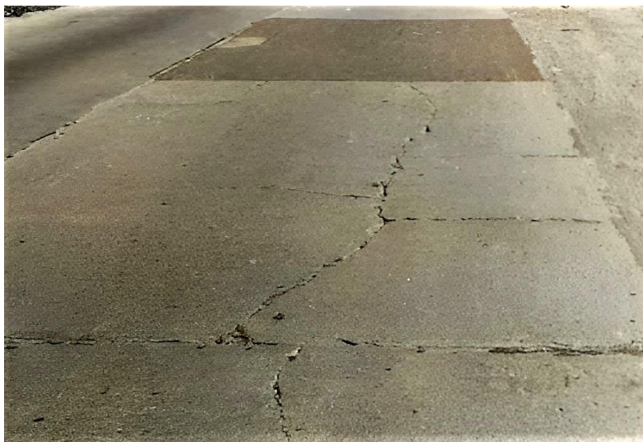
Figura 126: Fisura múltiple de media severidad. 131
