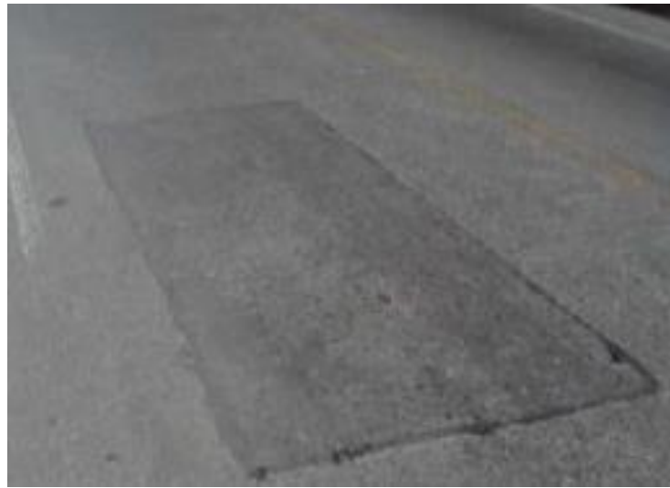
Figura 102: Bacheo de baja severidad. 107
