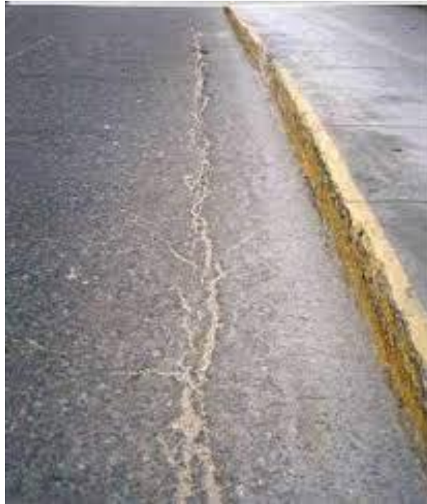
Figura 90: Desintegración de bordes de mediana severidad. 95
