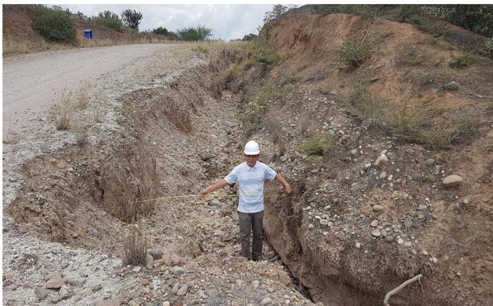
Figura 156: Drenaje inadecuado de alta severidad. 161
