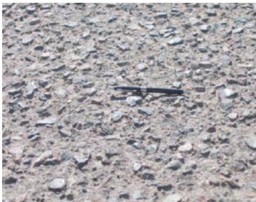
Figura 76: Desprendimiento/pérdida de agregado de alta severidad. 81
