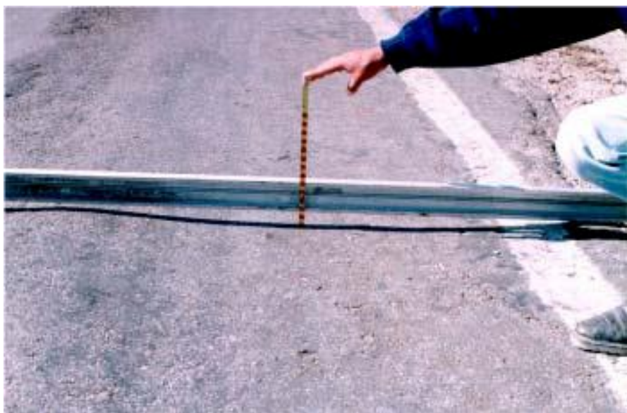
Figura 33: Ahuellamiento de severidad media con desplazamiento lateral. 38
