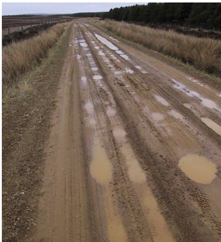
Figura 175: Ahuellamiento de alta severidad. 180
