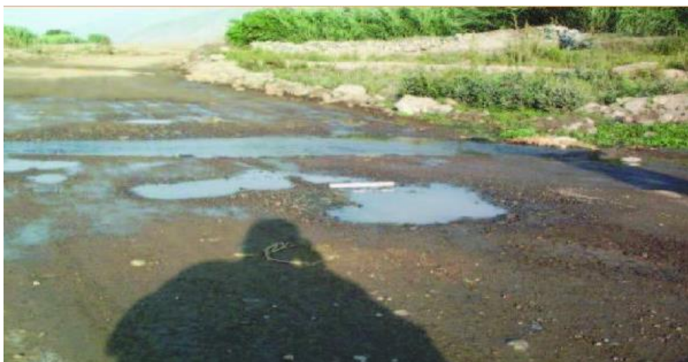
Figura 170: Bache de alta severidad. 175
