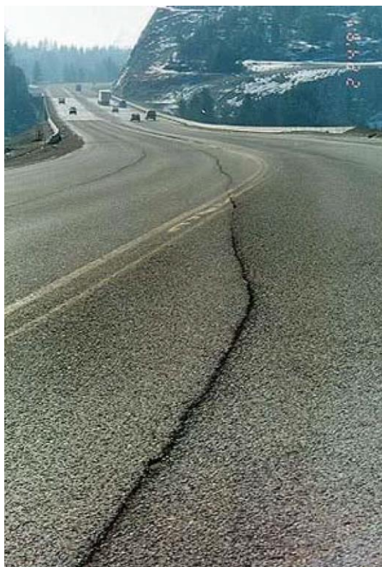
Figura 52: Fisura longitudinal de alta severidad. 57
