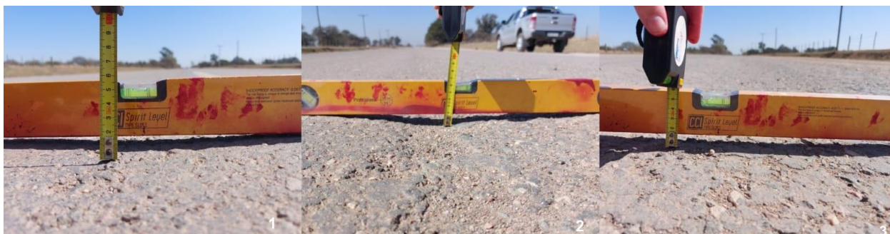
Figura 278: profundidades de ahuellamiento. Tramo 3
