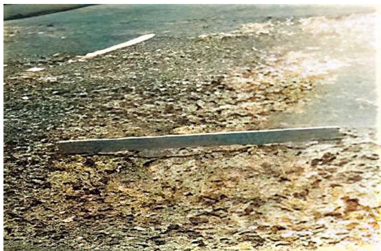
Figura 110: Peladuras de alta severidad. 115
