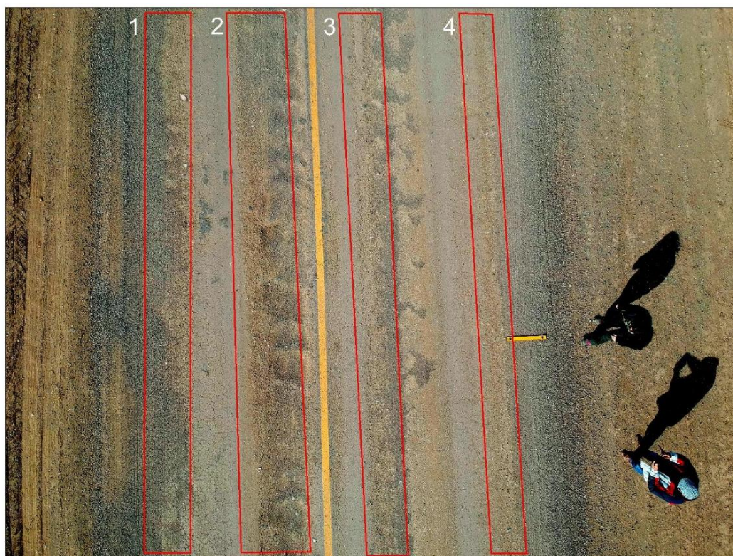
Figura 246: Ahuellamiento. Tramo 2 - imagen 0920.
