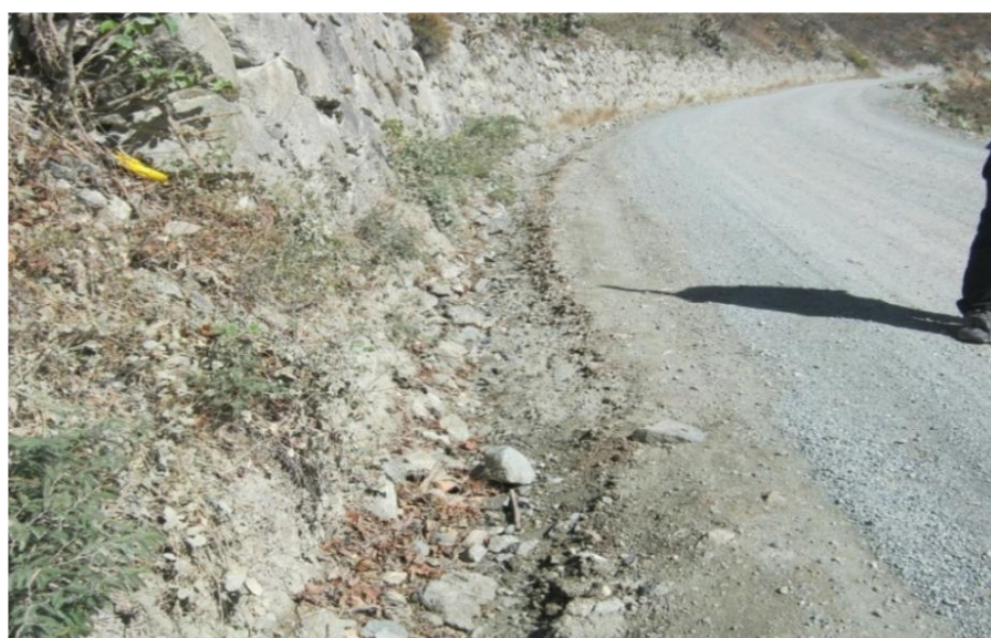
Figura 179: Pérdida de agregados de severidad media. 184
