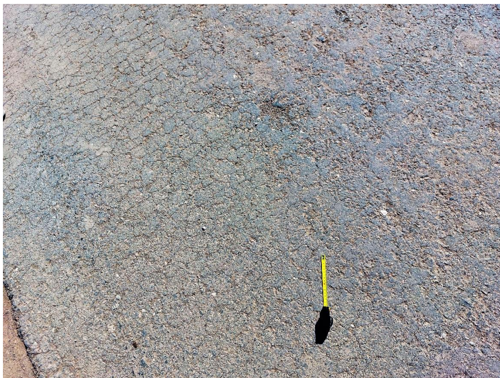
Figura 281: Fisuras tipo piel de cocodrilo en detalle. Tramo 3.
