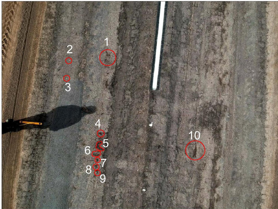
Figura 241: Desintegraciones por peladuras/ desprendimientos de agregados. Tramo 1 - imagen 0894.
