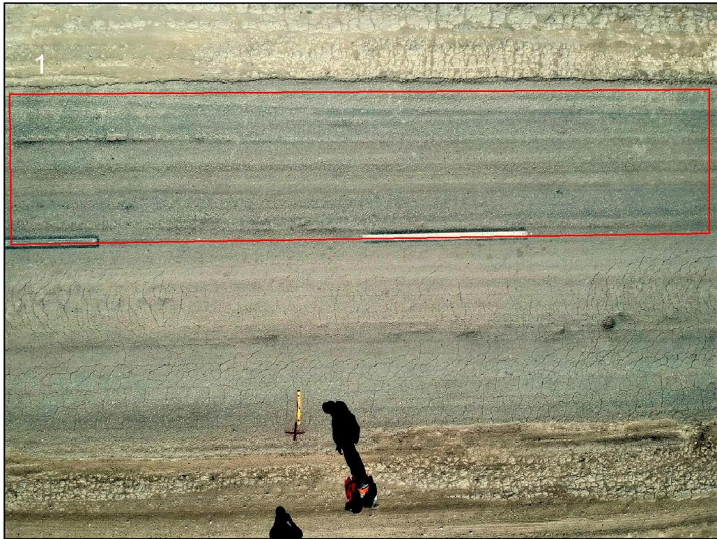
Figura 286: Estrías longitudinales. Tramo 3 - imagen 1256.
