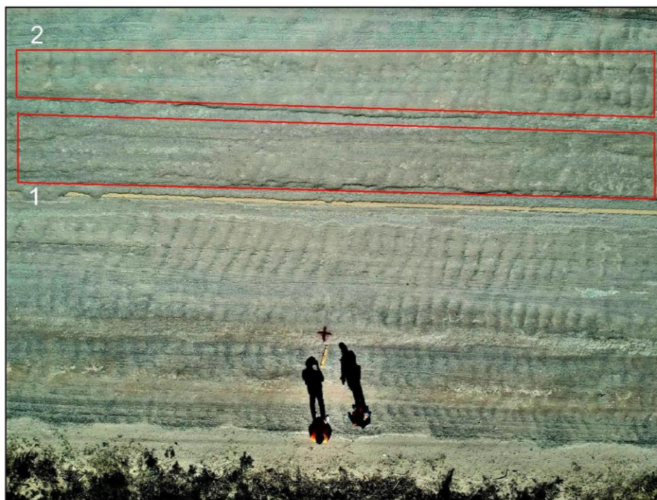
Figura 272: Ahuellamiento. Tramo 2 - imagen 1217.
