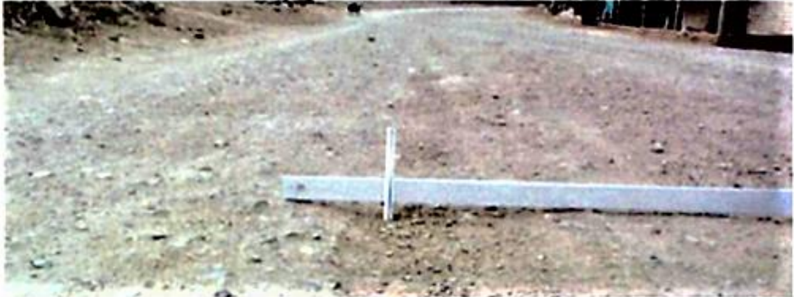
Figura 173: Ahuellamiento de baja severidad. 178
