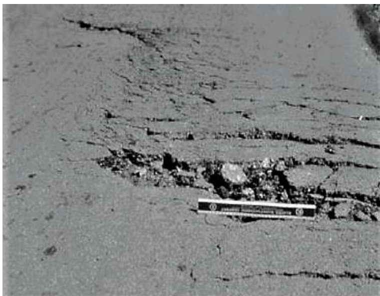
Figura 72: Fisuras en arco de alta severidad. 77
