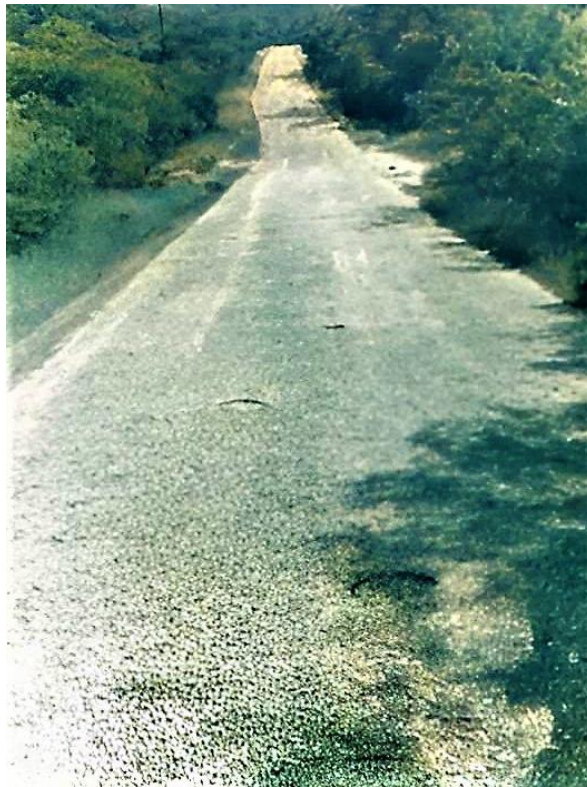
Figura 79: Peladura en tratamiento asfáltico. 84
