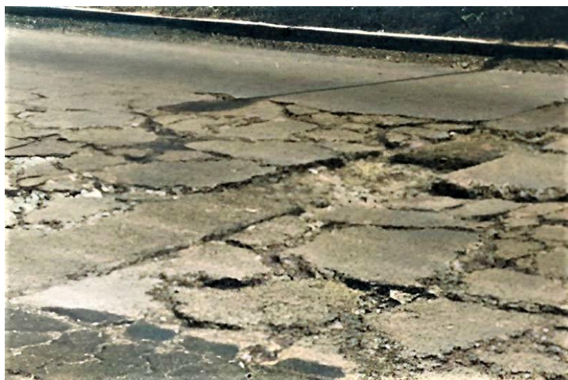
Figura 130: Fisuras y roturas en bloque de alta severidad. 135
