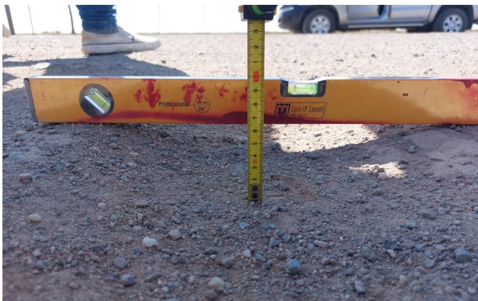
Figura 273: Profundidad de corrugaciones. Tramo 2.
