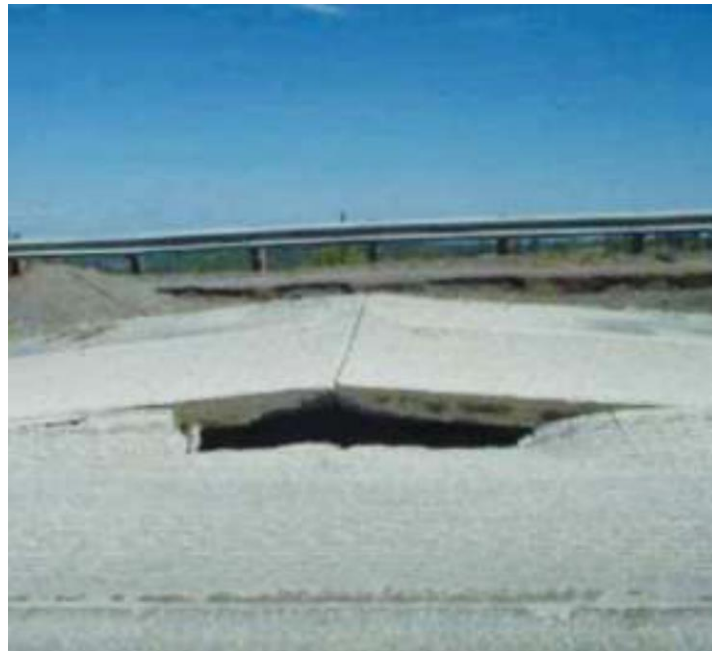
Figura 138: Levantamiento de losa de alta severidad. 143
