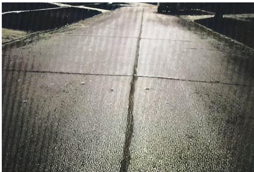
Figura 66: Reflexión de juntas con baja severidad. 71
