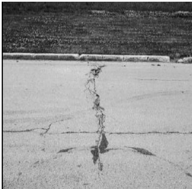
Figura 56: Fisura transversal con alto nivel de severidad. 61
