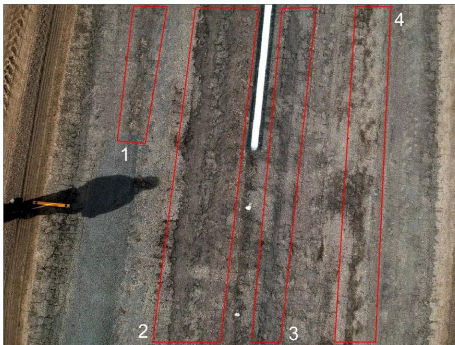
Figura 238: Ahuellamiento. Tramo 1 - imagen 0894.
