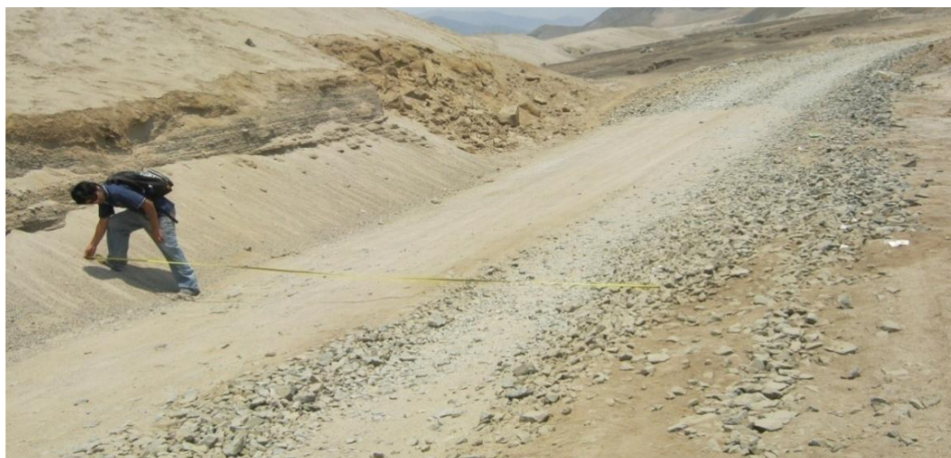
Figura 180: Pérdida de agregados de alta severidad. 185
