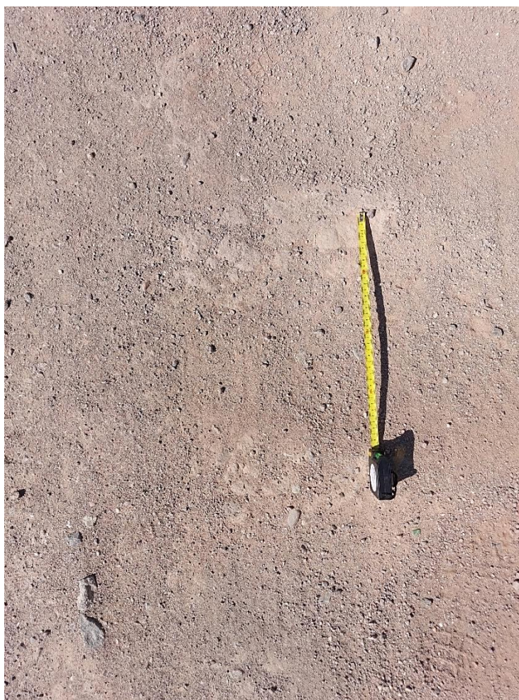
Figura 274: Separación entre crestas de corrugación. Tramo 2.
