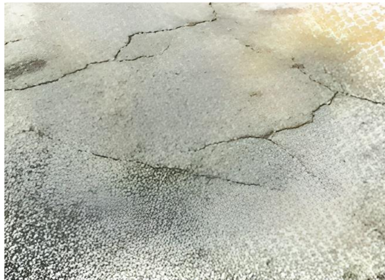
Figura 58: Fisuras en bloque con bajo nivel de severidad. 63
