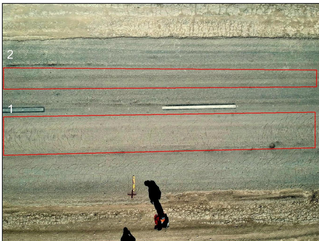
Figura 279: Ahuellamiento. Tramo 3 - imagen 1256.
