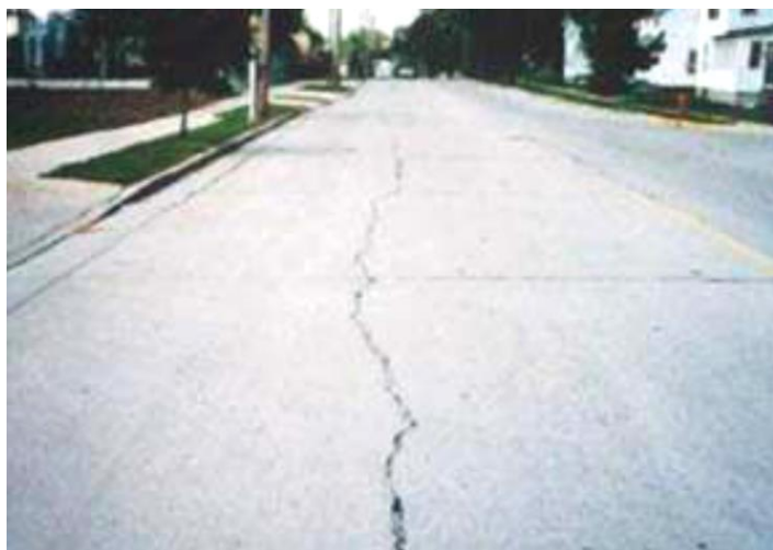
Figura 117: Fisura longitudinal de severidad media. 122
