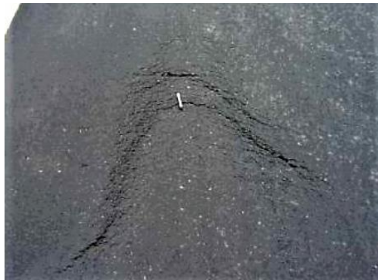
Figura 71: Fisuras en arco con nivel medio de severidad 76 .
