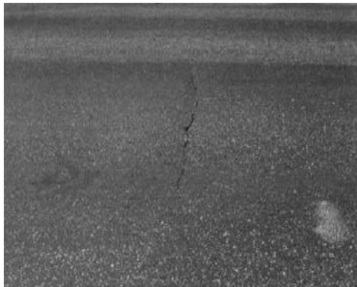
Figura 54: Fisura transversal con bajo nivel de severidad. 59
