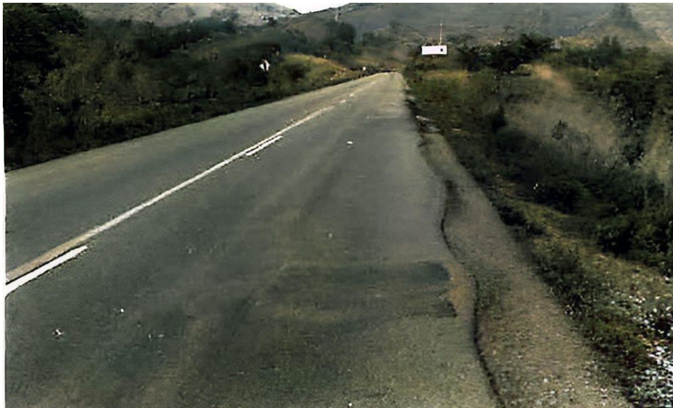
Figura 44: Corrimiento de mediana severidad. 49
