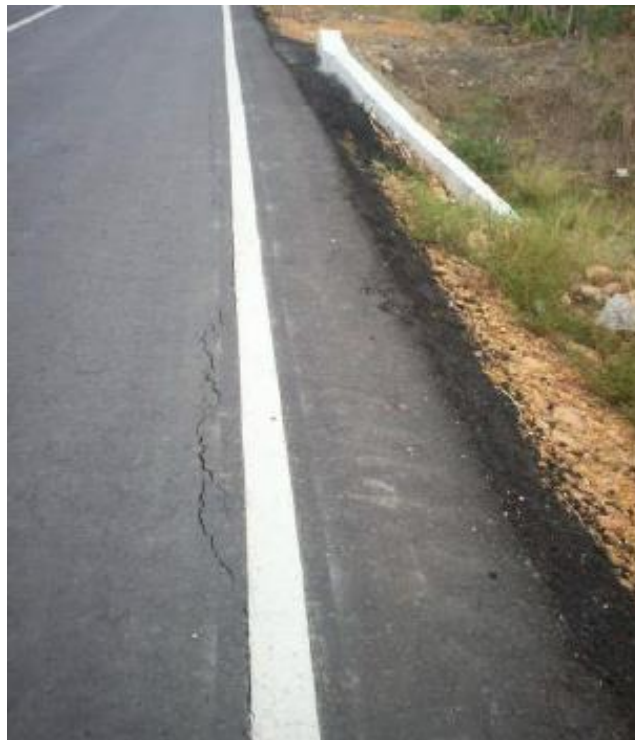
Figura 89: Grieta de borde de baja severidad. 94
