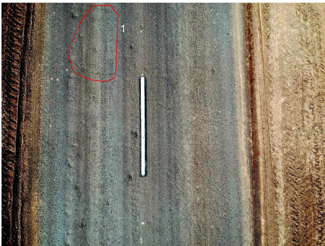
Figura 255: Fisuras transversales. Tramo 3 - imagen 0934.
