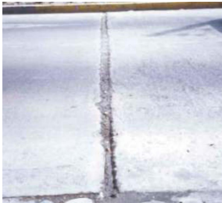
Figura 143: Deficiencia del material de sello de alta severidad. 148
