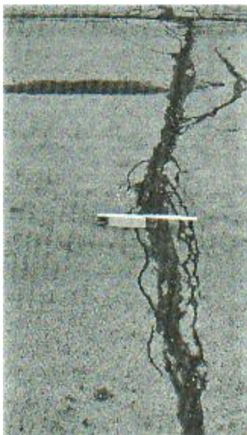
Figura 68: Reflexión de juntas con alto nivel de severidad. 73
