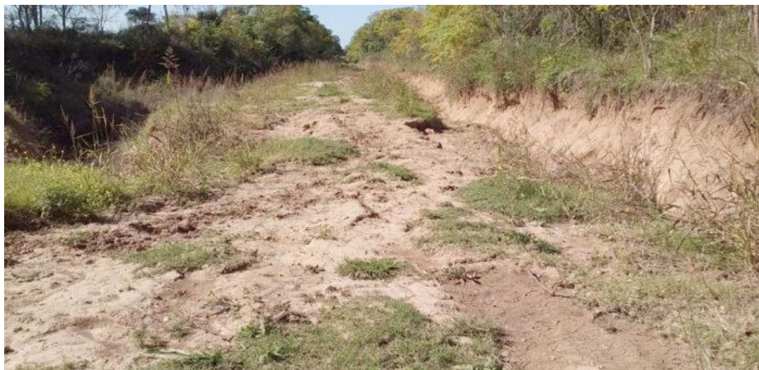
Figura 151: Pérdida del perfil transversal de alta severidad. 156
