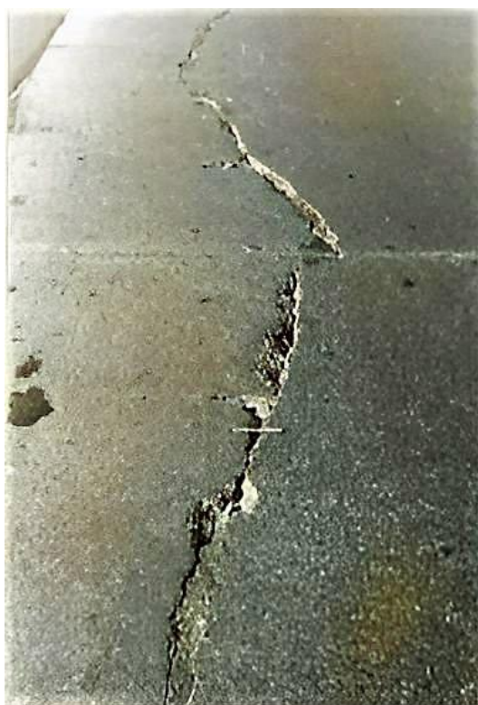
Figura 118: Fisuración longitudinal de alta severidad. 123
