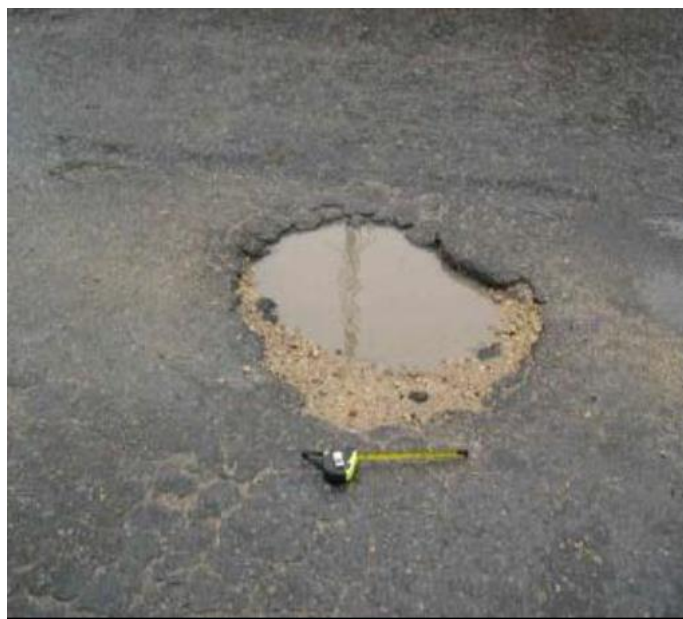
Figura 86: Baches de mediana severidad. 91
