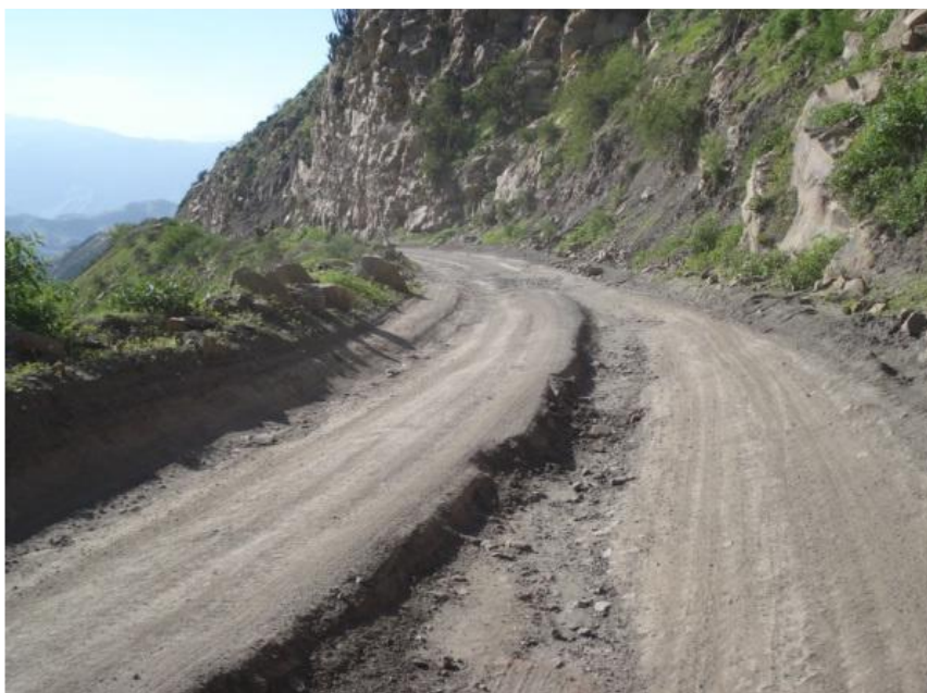
Figura 183: Surcos erosivos con alta severidad. 188
