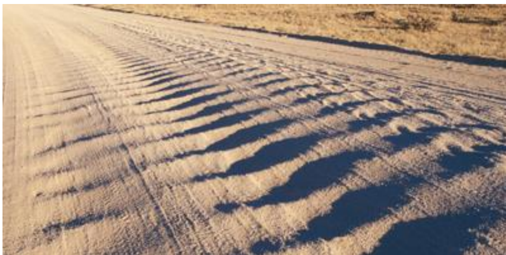
Figura 161: Corrugación/ Ondulación de alta severidad. 166
