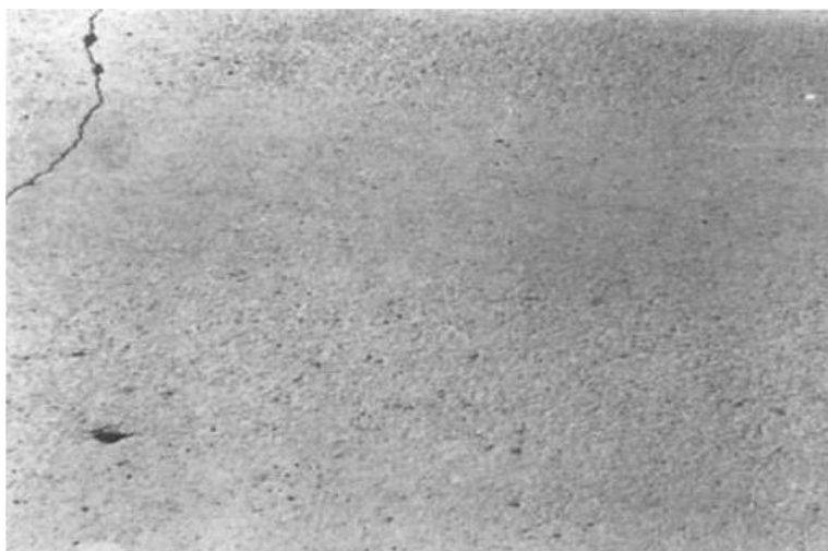
Figura 108: Peladuras de baja severidad. 113
