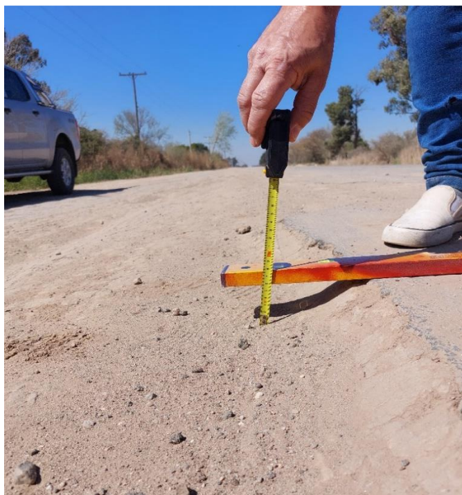
Figura 268: Escalonamiento de borde. Tramo 1 – imagen 2.
