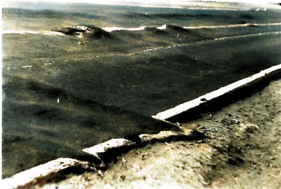
Figura 45: Corrimiento de alta severidad. 50
