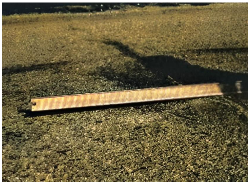
Figura 36: Deformación por hundimiento de baja severidad. 41
