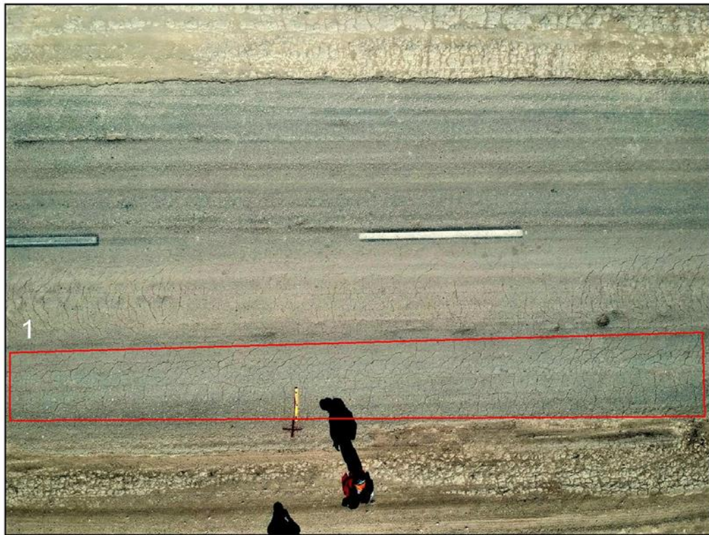
Figura 280: Fisuras tipo piel de cocodrilo. Tramo 3 - imagen 1256.
