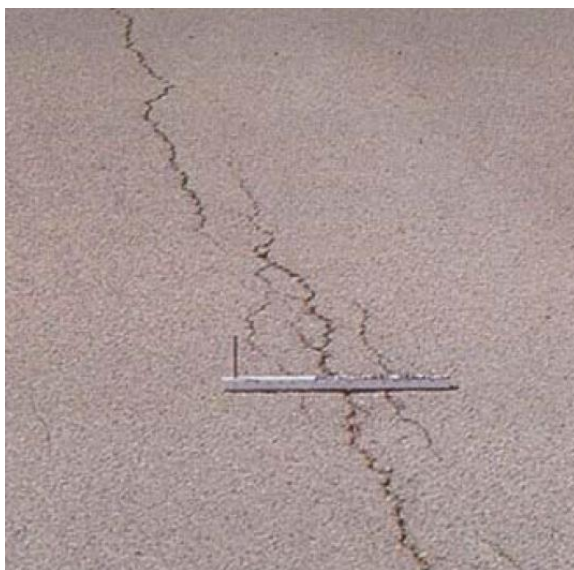
Figura 51: Fisura longitudinal de severidad media. 56
