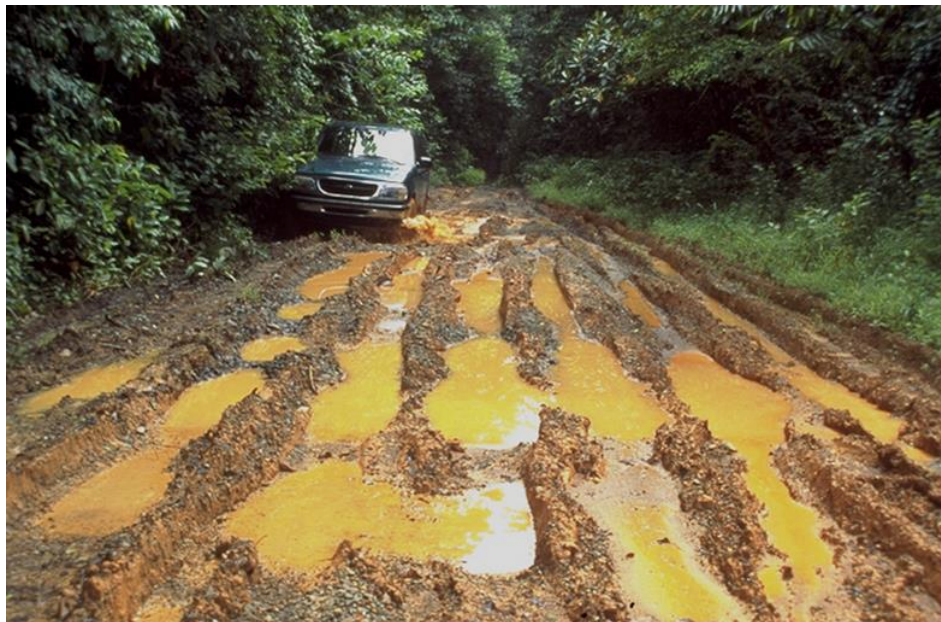
Figura 155: Drenaje inadecuado de alta severidad. 160
