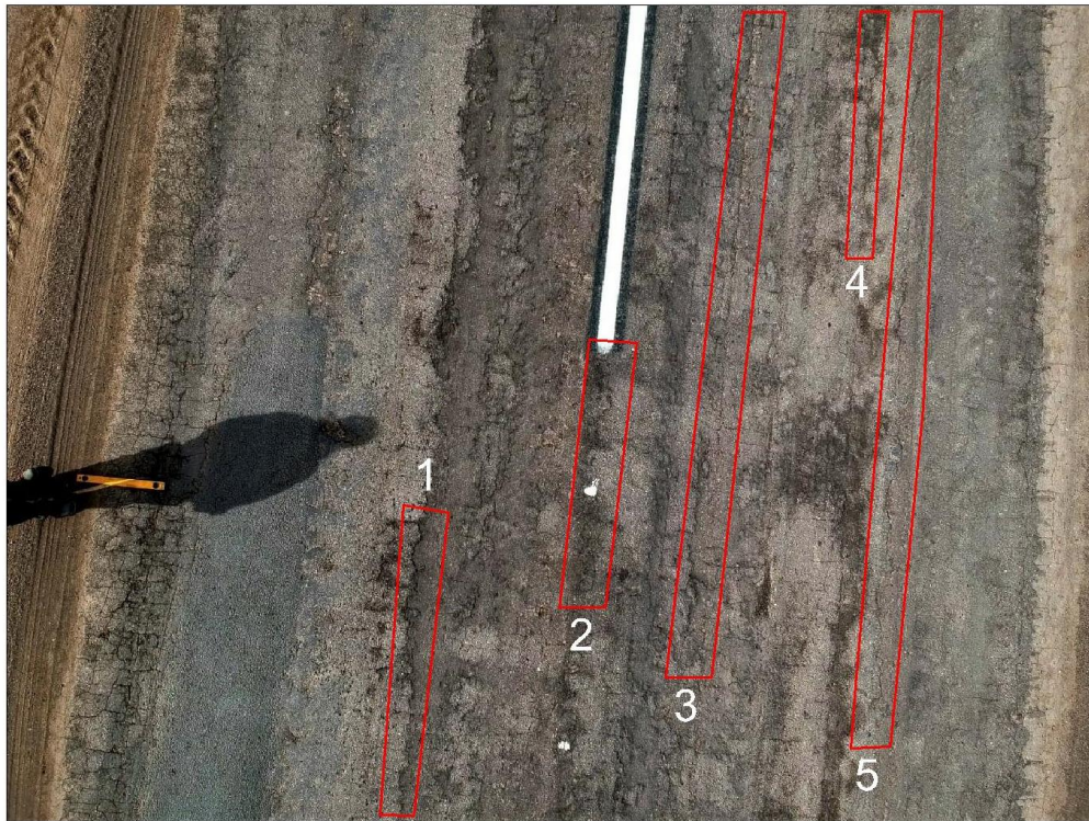
Figura 239: Fisuras longitudinales. Tramo 1 - imagen 0894.
