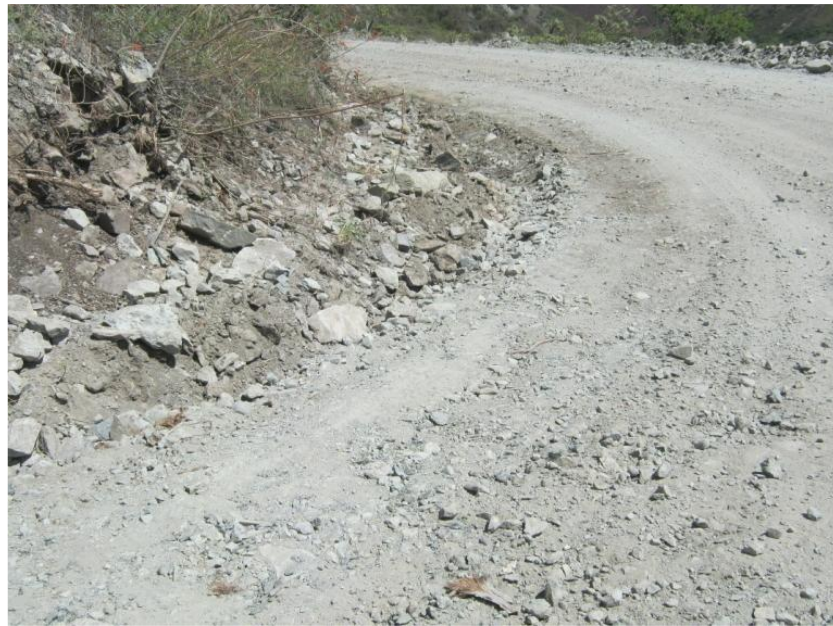
Figura 154: Drenaje inadecuado de severidad media. 159
