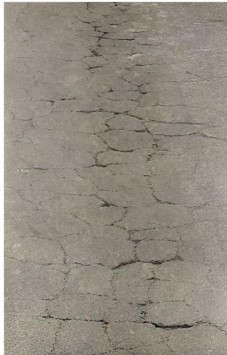
Figura 63: Fisuras tipo piel de cocodrilo de severidad media. 68
