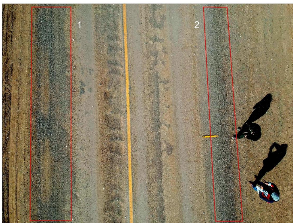
Figura 248: Pérdida de agregados. Tramo 2 - imagen 0920.
