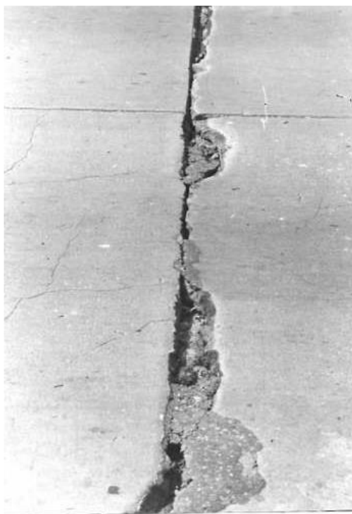
Figura 147: Descascamiento de juntas de alta severidad. 152
