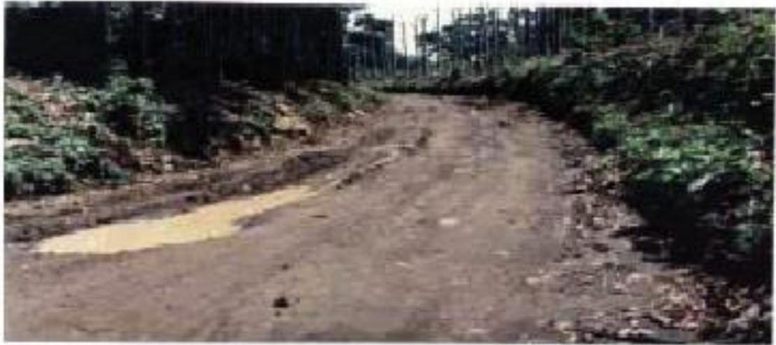
Figura 150: Pérdida del perfil transversal de mediana severidad. 155
