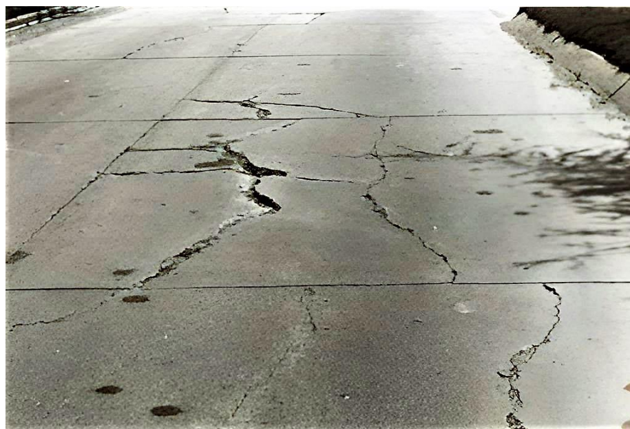
Figura 127: Fisura múltiple de alta severidad. 132
