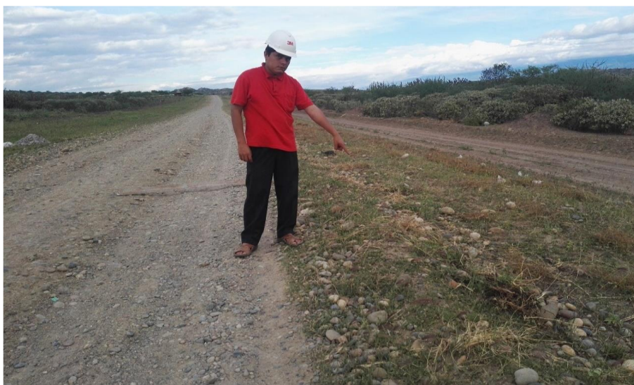
Figura 153: Drenaje inadecuado de baja severidad. 158
