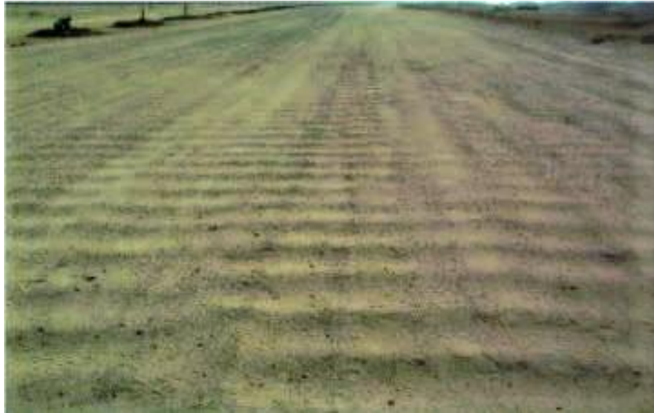
Figura 159: Corrugación/ ondulación de baja severidad. 164
