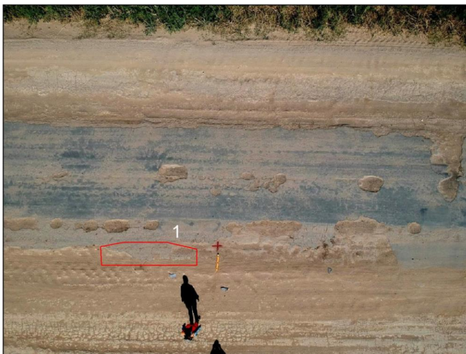
Figura 263: Fisuras tipo piel de cocodrilo. Tramo 1- imagen 1204.
