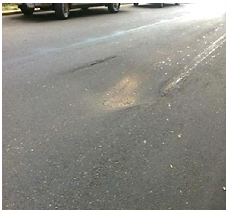
Figura 37: Deformación por hundimiento de alta severidad. 42
