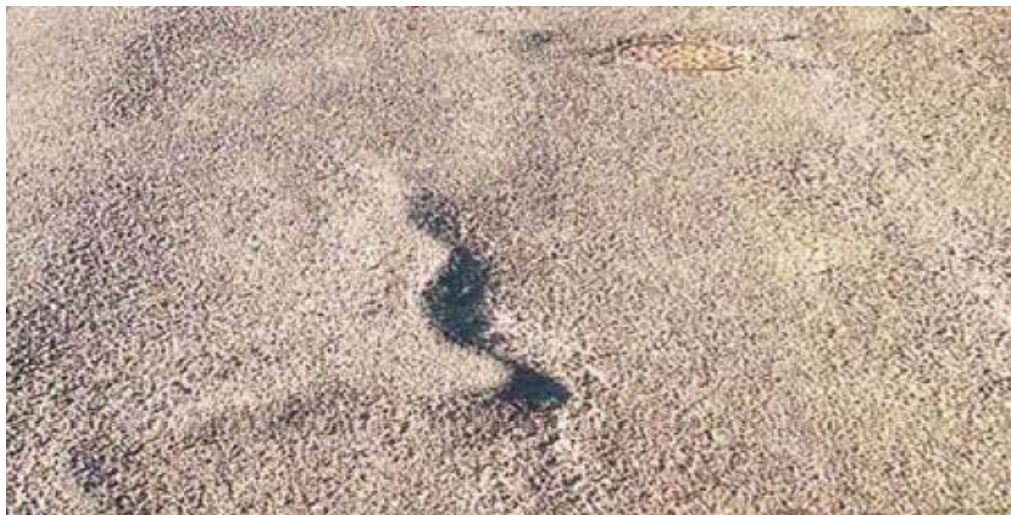
Figura 43: Corrimiento de baja severidad. 48
