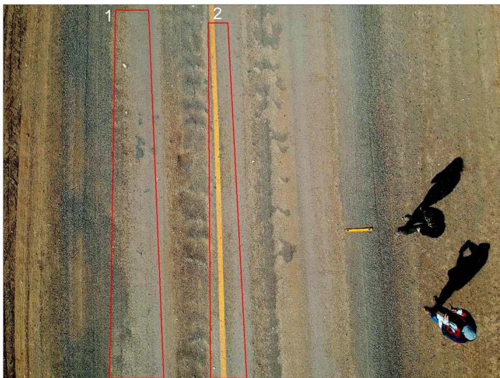
Figura 247: Fisuras tipo piel de cocodrilo. Tramo 2 - imagen 0920.
