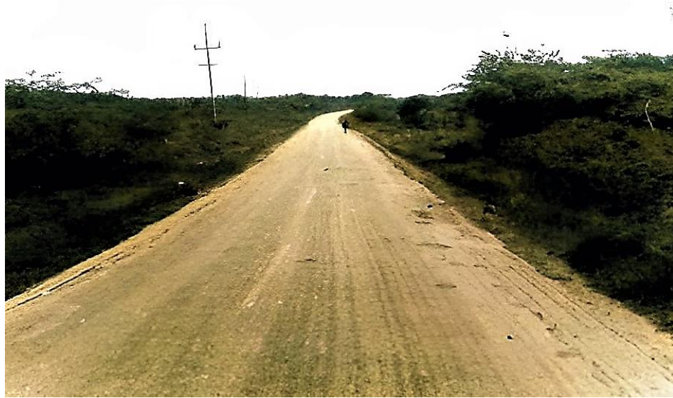
Figura 81: Estrías longitudinales de baja severidad. 86
