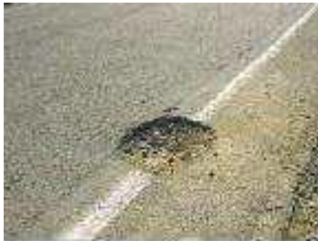
Figura 85: Desintegración por bache de baja severidad. 90
