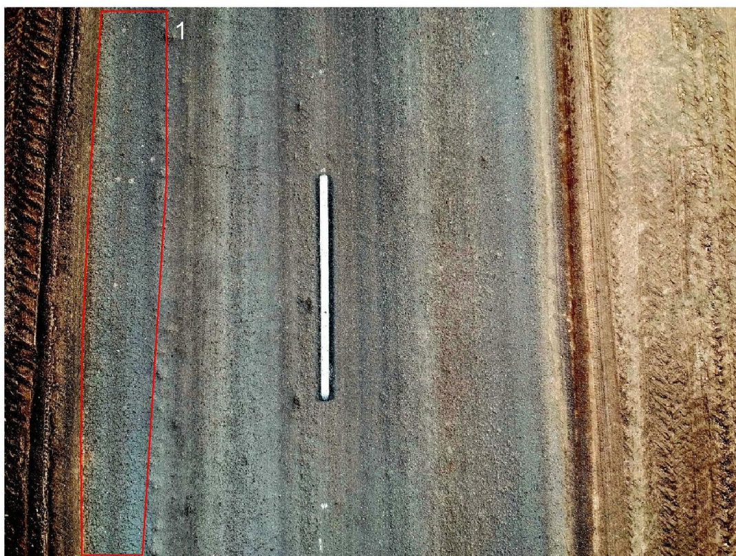
Figura 256: Fisuras tipo piel de cocodrilo. Tramo 3 - imagen 0934.
