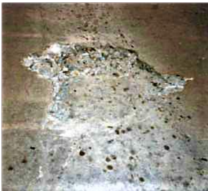
Figura 129: Bache de pavimento rígido de alta severidad. 134
