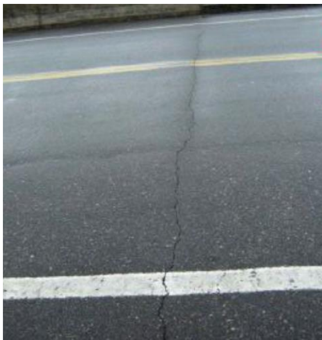
Figura 55: Fisura transversal con nivel de severidad medio. 60
