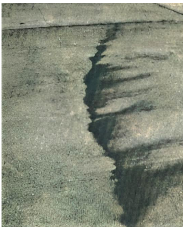
Figura 100: Falla por exudación de agua y bombeo. 105
