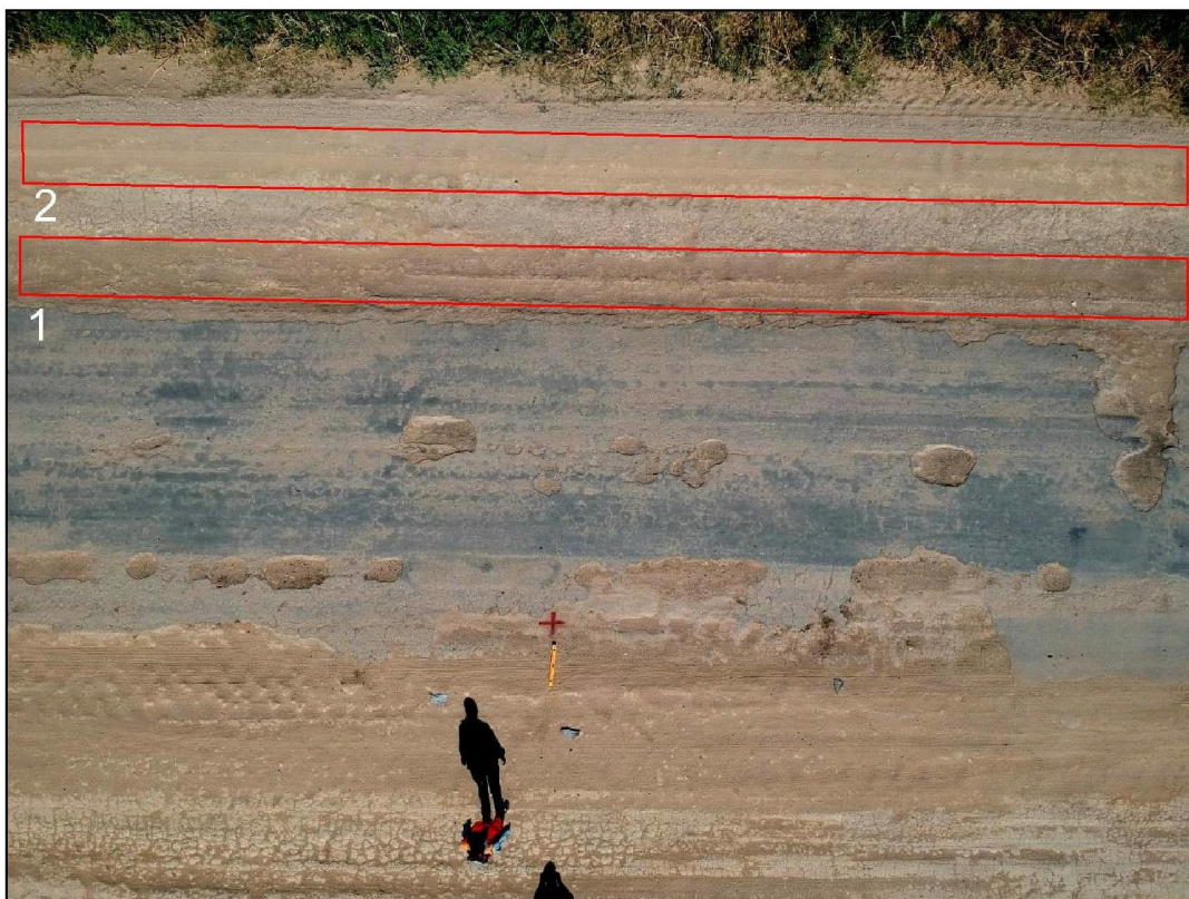
Figura 261: Ahuellamiento. Tramo 1 - imagen 1204.
