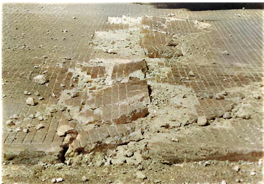
Figura 140: Estallido por compresión. 145
