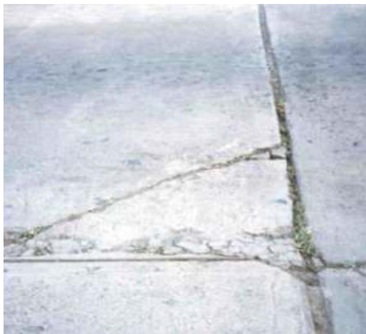
Figura 124: Fisuración de esquina de severidad media. 129
