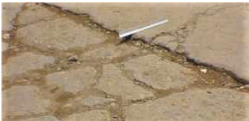
Figura 134: Escalonamiento de severidad media. 139
