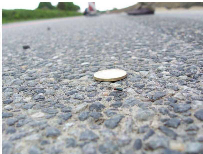
Figura 75: Desprendimiento/pérdida de agregados de mediana intensidad. 80
