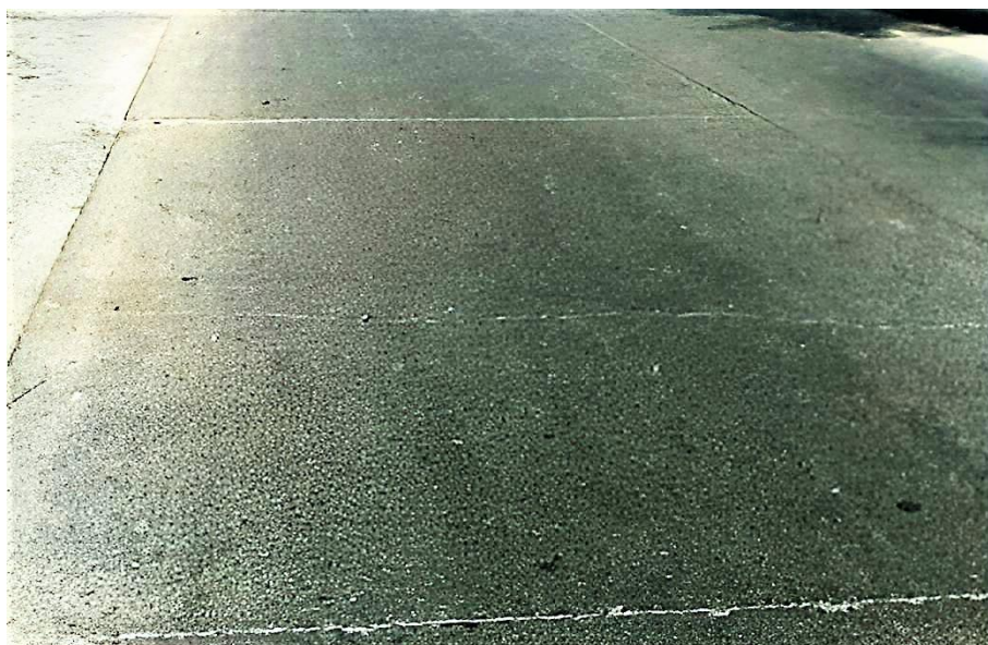
Figura 121: Fisuras transversales de severidad media. 126
