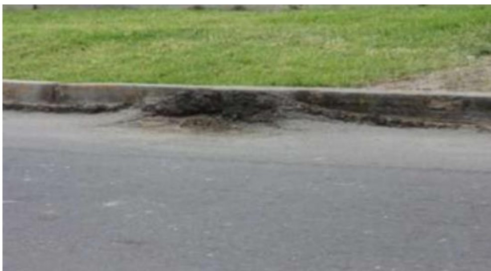
Figura 48: Hinchamiento de alta severidad. 53
