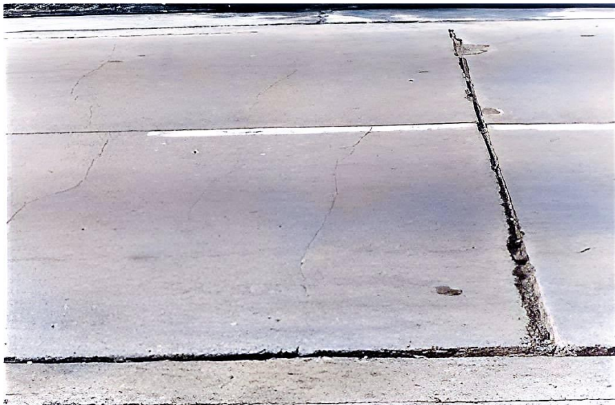
Figura 120: Fisura transversal de baja severidad. 125
