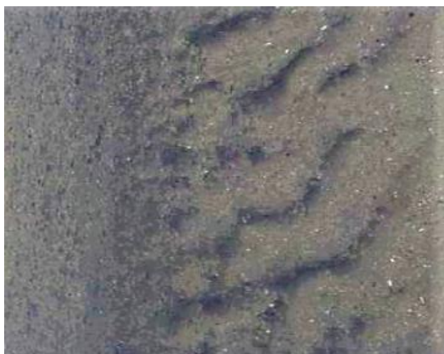
Figura 95: Exudación de baja severidad. 100
