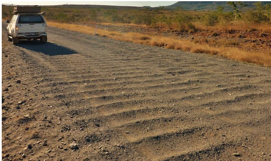
Figura 160: Corrugación/Ondulación de mediana severidad. 165
