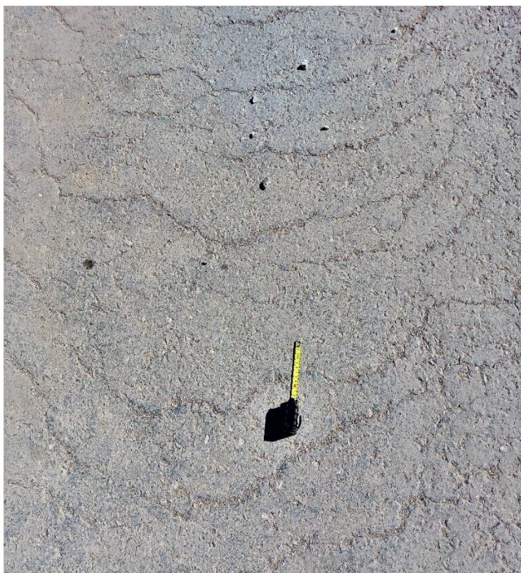
Figura 282: Fisuras parabólicas en detalle. Tramo 3.
