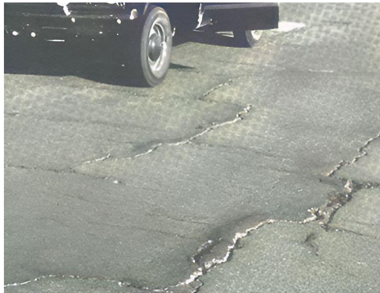
Figura 60: Fisuras en bloque con alto nivel de severidad. 65
