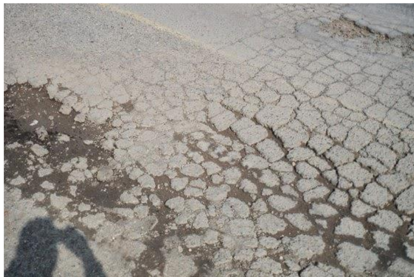
Figura 64: Fisuras tipo piel de cocodrilo con alto nivel de severidad. 69
