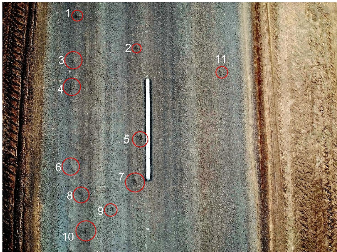
Figura 257: Desintegración por peladuras. Tramo 3 - imagen 0934.
