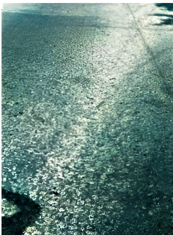
Figura 109: Peladuras de severidad media. 114
