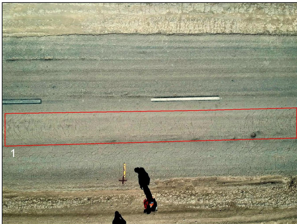
Figura 283: Fisuras parabólicas. Tramo 3 - imagen 1256.
