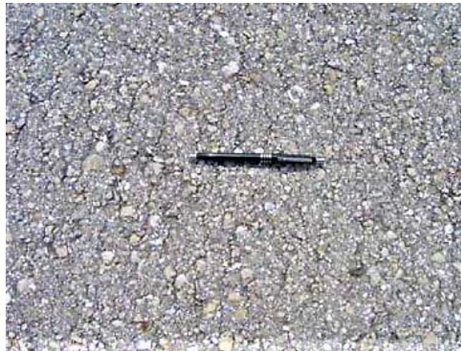
Figura 74: Desprendimiento/Pérdida de agregado con bajo nivel de severidad. 79
