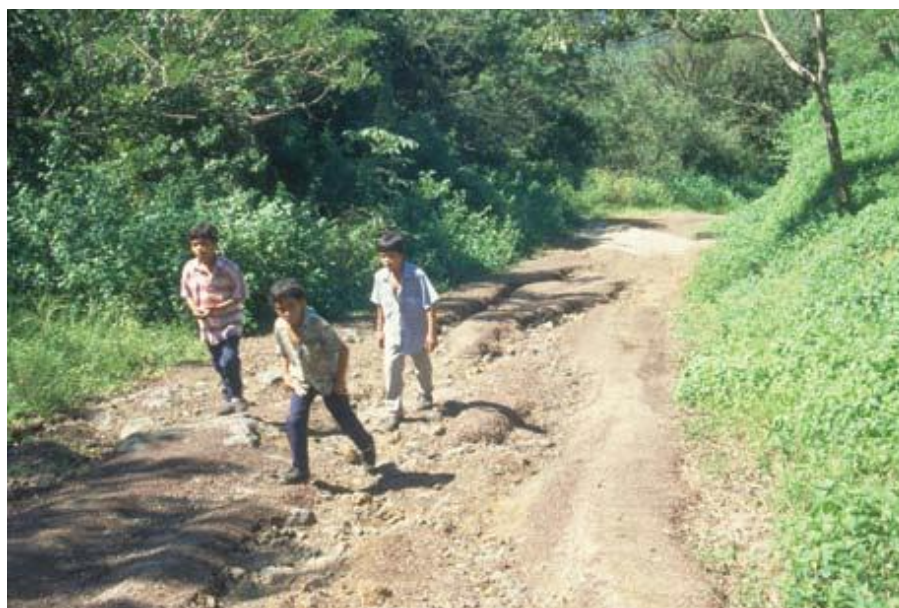
Figura 182: Surcos de erosión de mediana y alta severidad. 187
