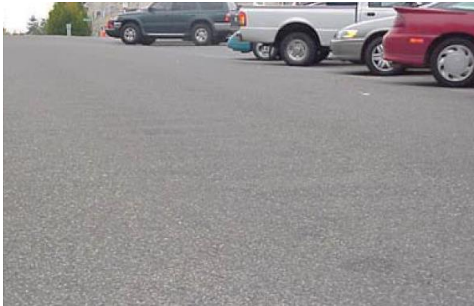
Figura 39: Corrugación con bajo nivel de severidad. 44
