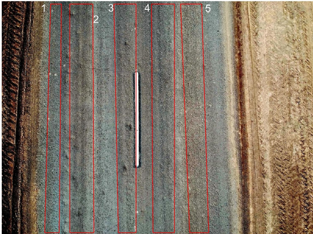
Figura 253: Ahuellamiento. Tramo 3 - imagen 0934.
