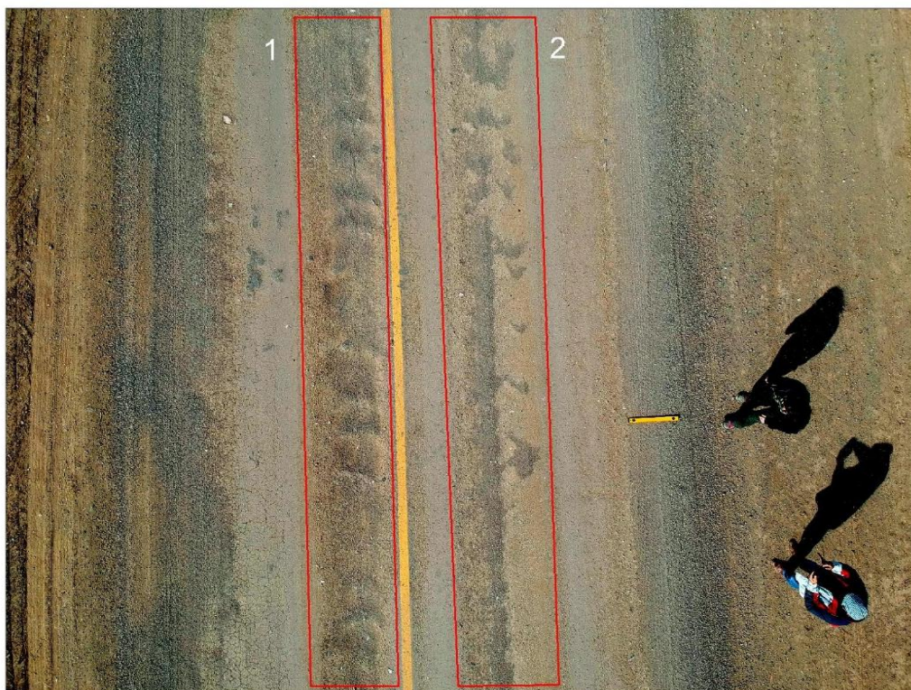
Figura 249: Corrugación y baches. Tramo 2 - imagen 0920.
