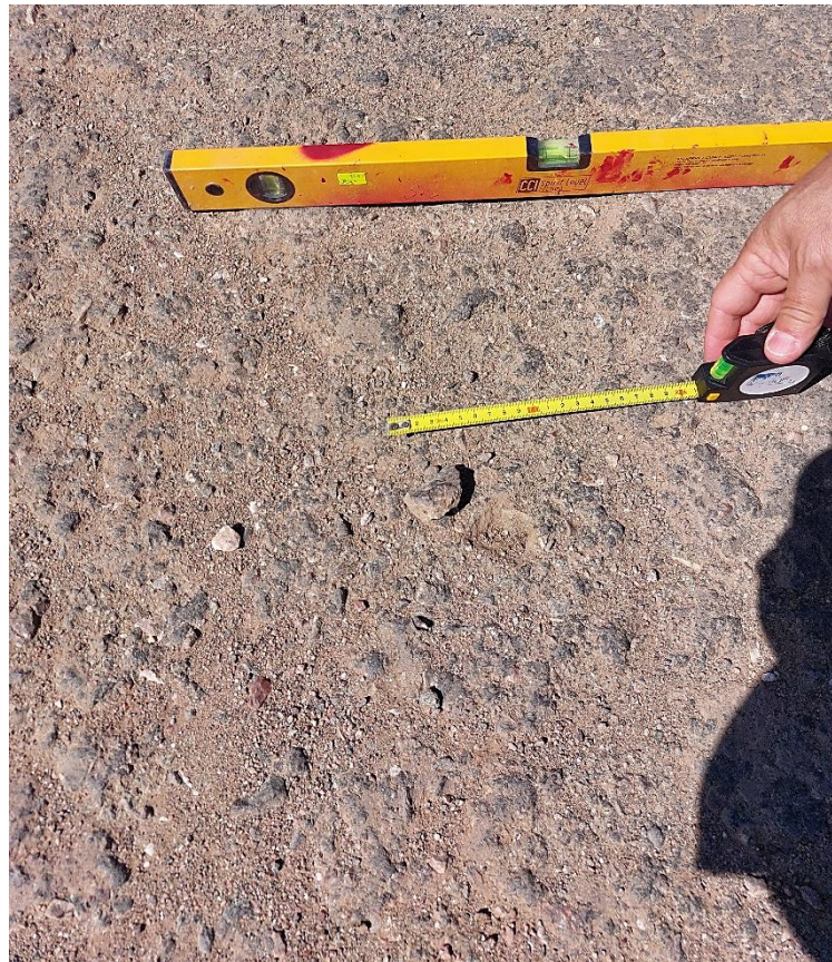
Figura 284: Detalle de pérdida de agregados. Tramo 3.
