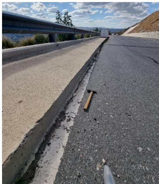
Figura 84. Asentamiento de la calzada.
