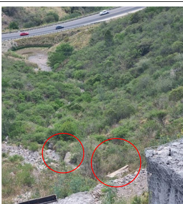
Figura 81. Restos del muro de hormigón.
