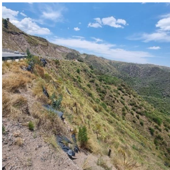
Figura 85. Deslizamiento del talud.
