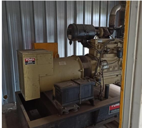
Imagen 169 - Generador de energía eléctrica a reutilizar
