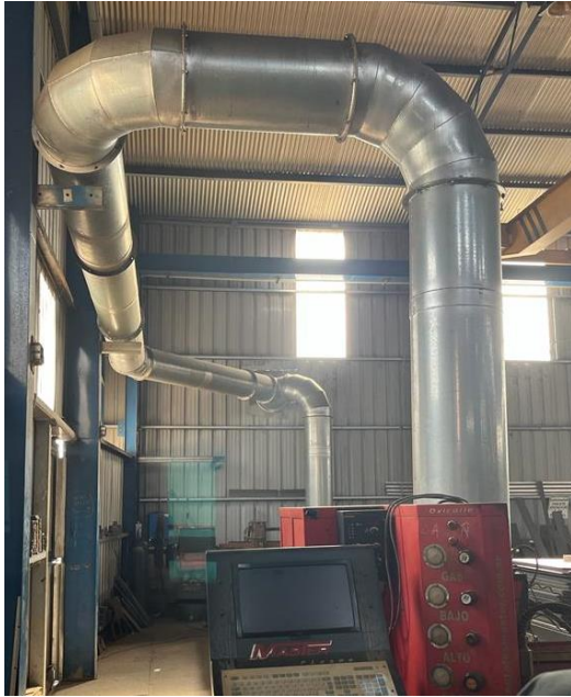
Imagen 167 - Cañería del extractor de humo actual
