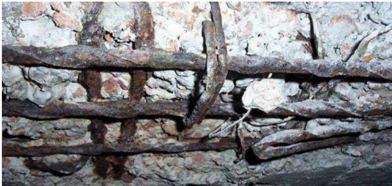
Figura V-4 – Corrosión del acero en el hormigón armado.
