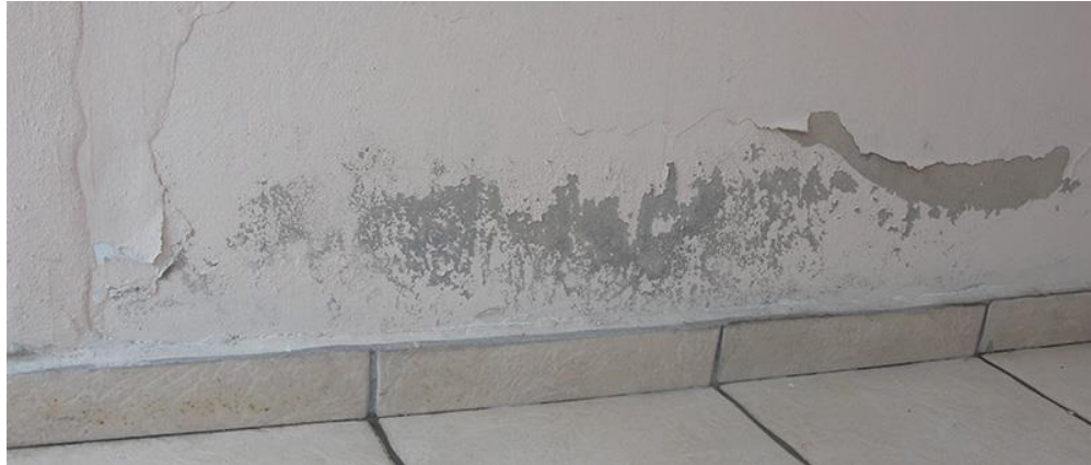
Figura V-1 – Humedad por capilaridad.
