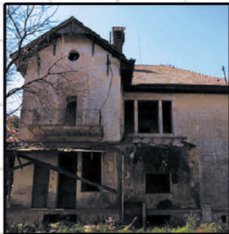
Deteriorado o en Desuso.
