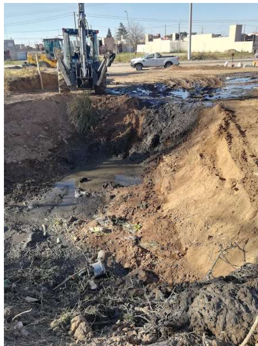
FOTOGRAFÍA N° 14: Canal ya taponado
