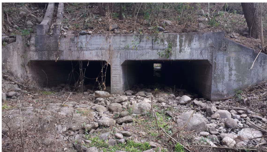
Figura 10 -Estado actual de las alcantarillas
