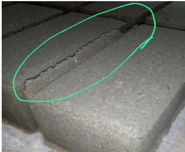
Ilustración 59 - Bisel mal terminado
