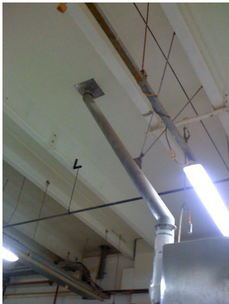
Figura 10: Bajada actual, una sola boca de alimentación (Antes).
